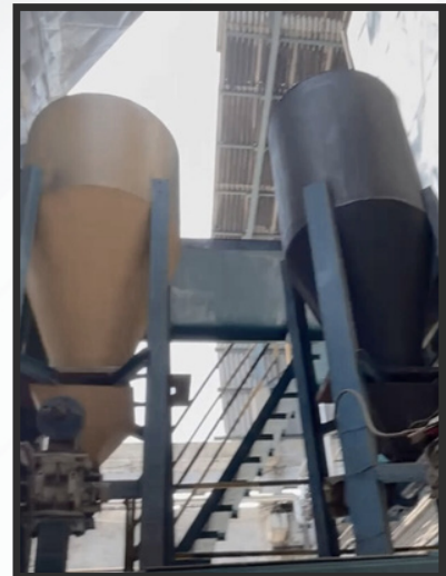
PAC & Lime dosing
